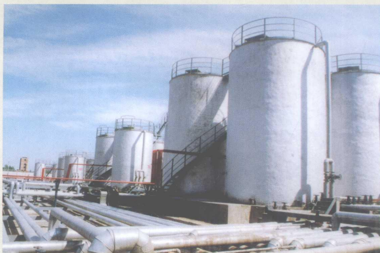
长城润滑油燕化分公司罐区
