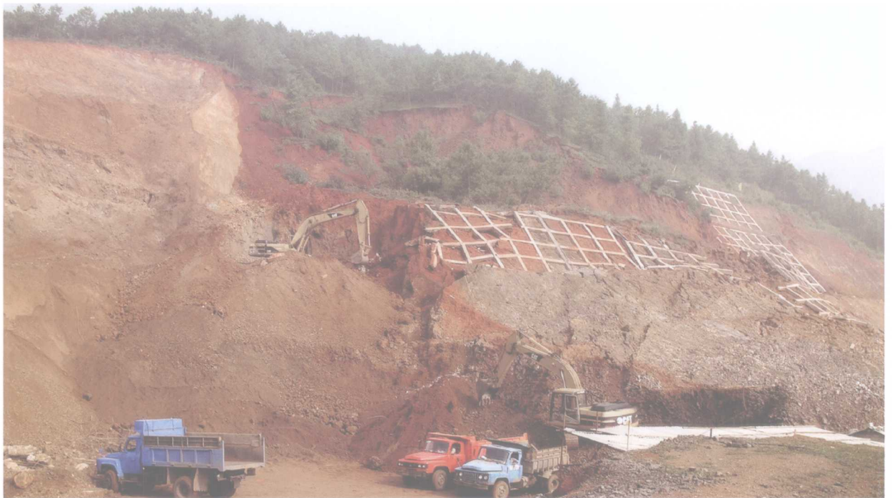
图1.7 某山区高速公路路堑高边坡在施工中发生滑坡，已施工的防护工程遭到破坏。
