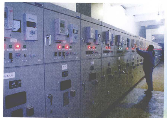
供电系统（配电室一角）
