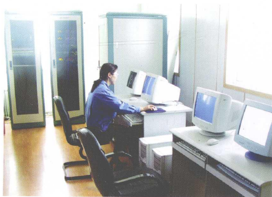
网络中心机房
