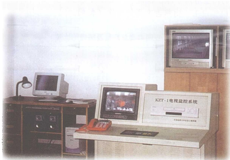
先进的闭路电视监控系统
