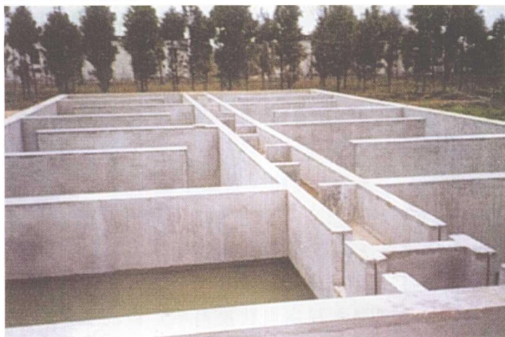
先进的污水处理设施
