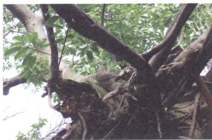
塔顶上的榕树树径达30多公分
