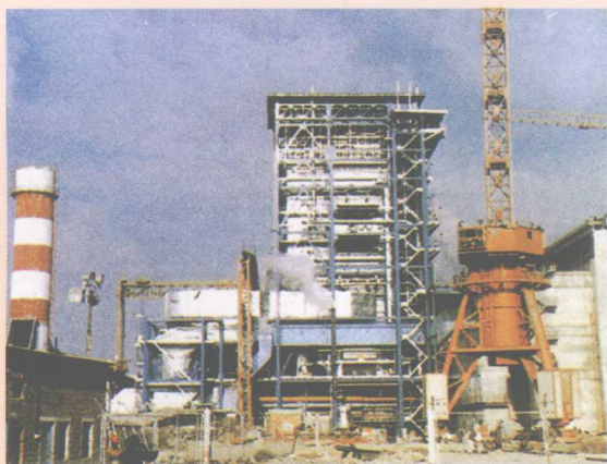
巴基斯坦古杜电站的680t/h燃油锅炉
