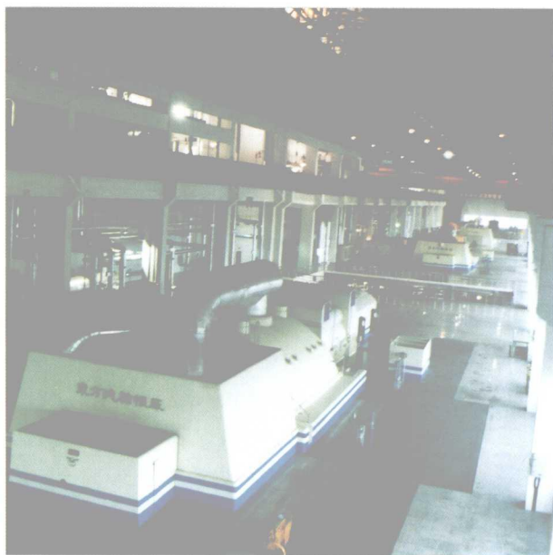
安顺发电厂主机房
