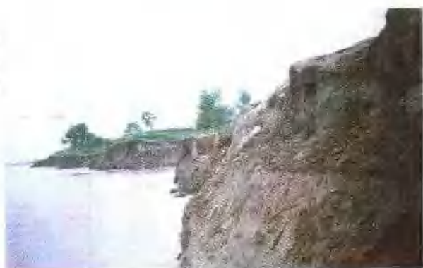
未修复的鄂州市 耙铺大堤郑家湾险段 (市水利局供稿)
