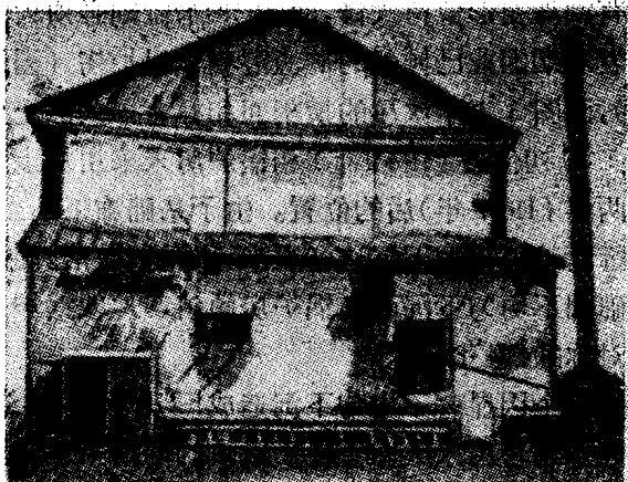
图2 矿渣混凝土锅炉房的变形
