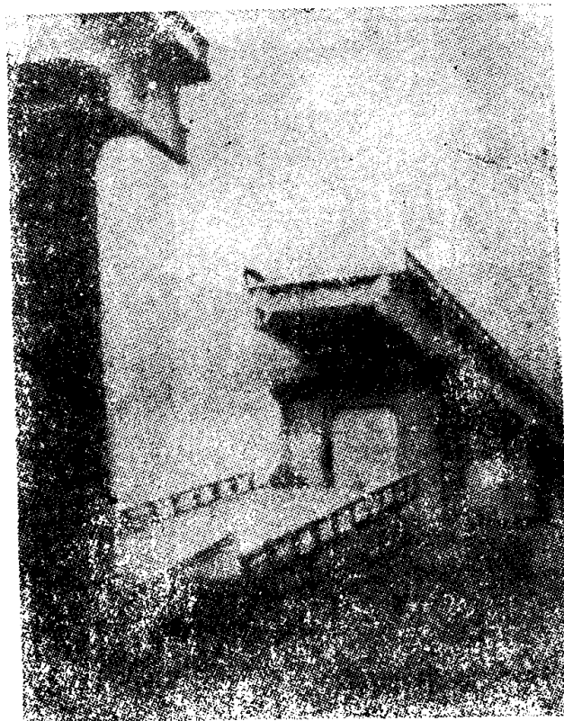
由于相邻主梁之间过大的相对运动使锦樱桥的跨一悬挂梁掉落在地面。
