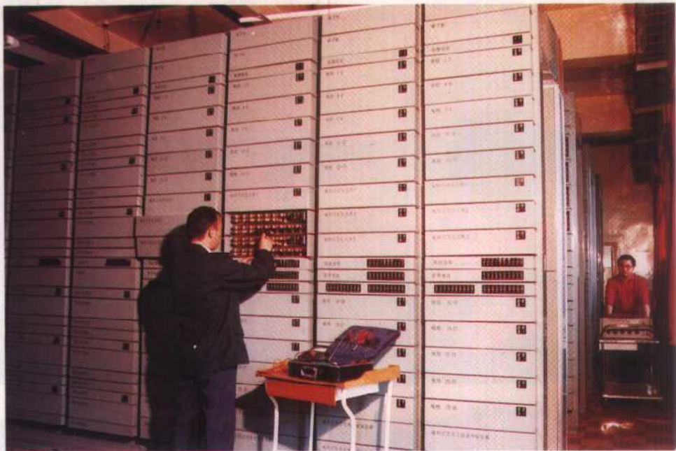
临泉县邮电局 自动电话市机室
