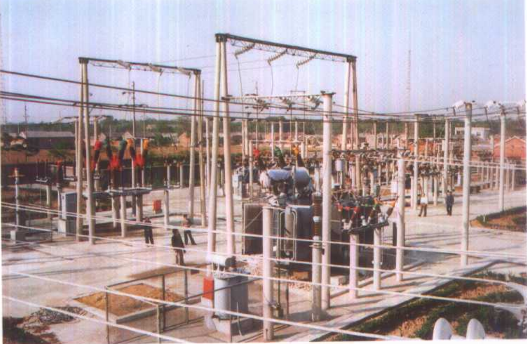
临泉县供电局11万千伏输变电工程
