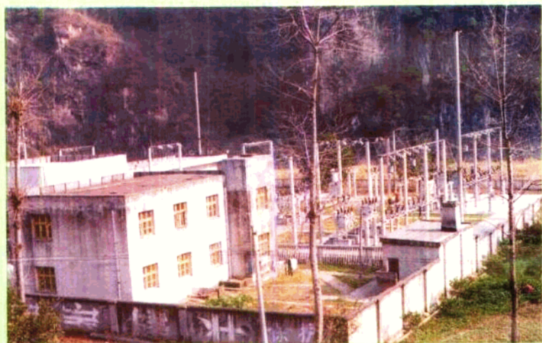
易家坝变电站
