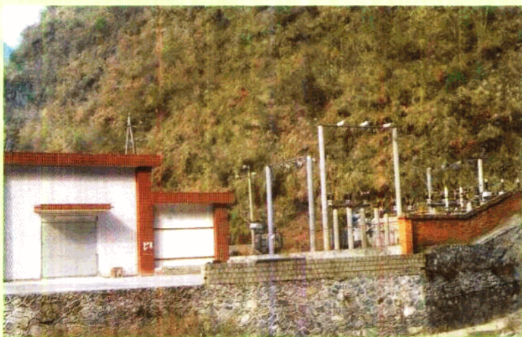
乡建水电站这之一——易家坝电站
