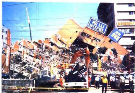
坍塌后的台北市八德路东星大楼(松山宾馆)。
