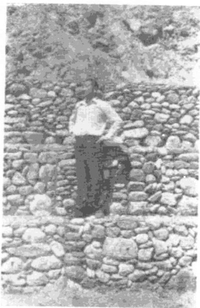
西班牙四号公路上防滑坡滚石的石墙挡墙
