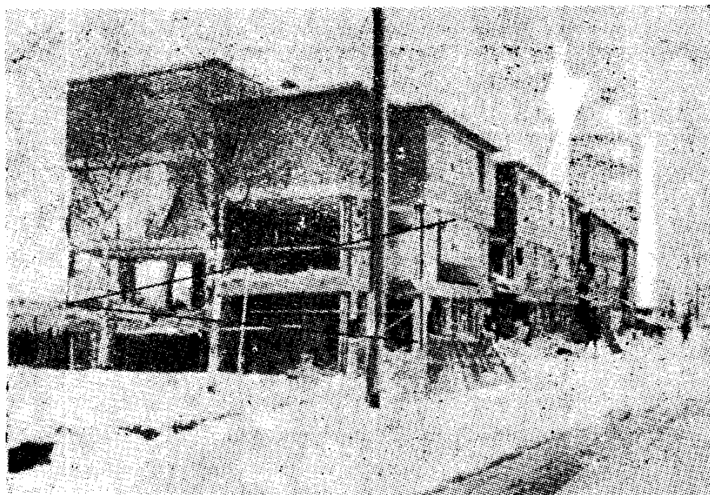
图 1-6 端面看去后墙中间受到严重破坏，以及墙壁 的第一层和第二层楼的受损情况
