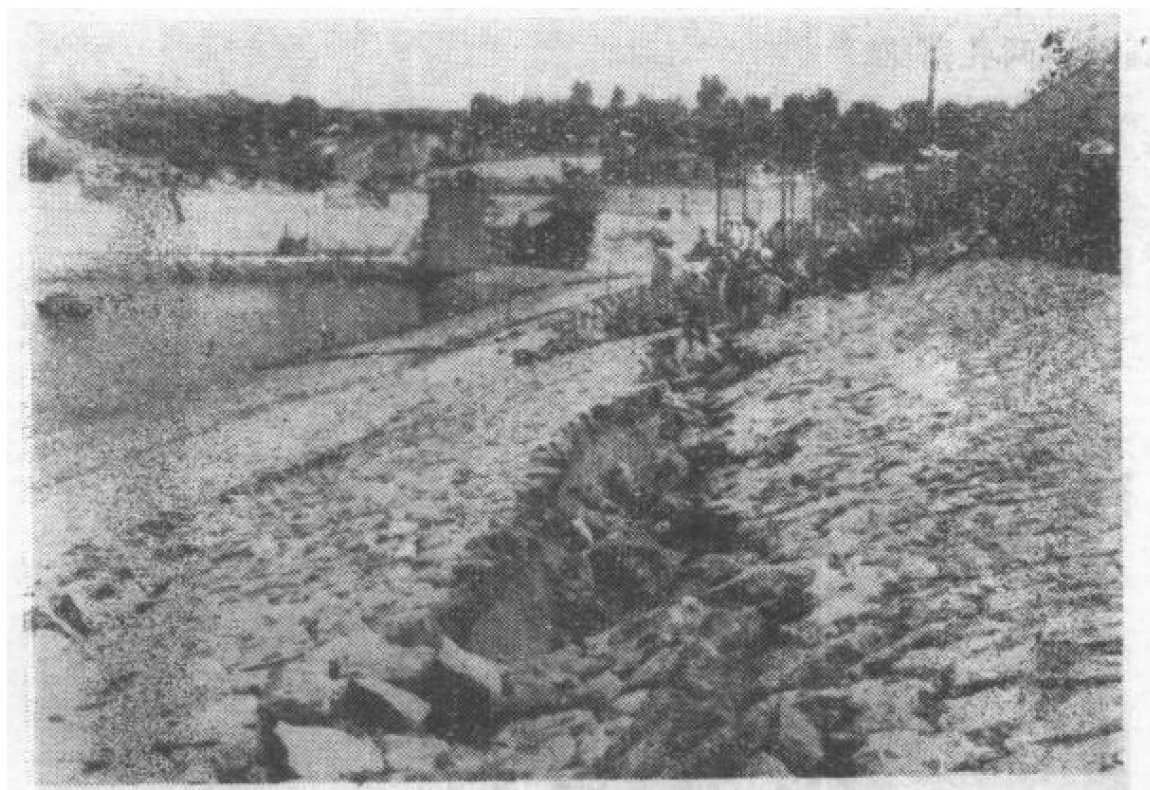
图 1.5 陡河水库土坝上游坡纵向裂缝
