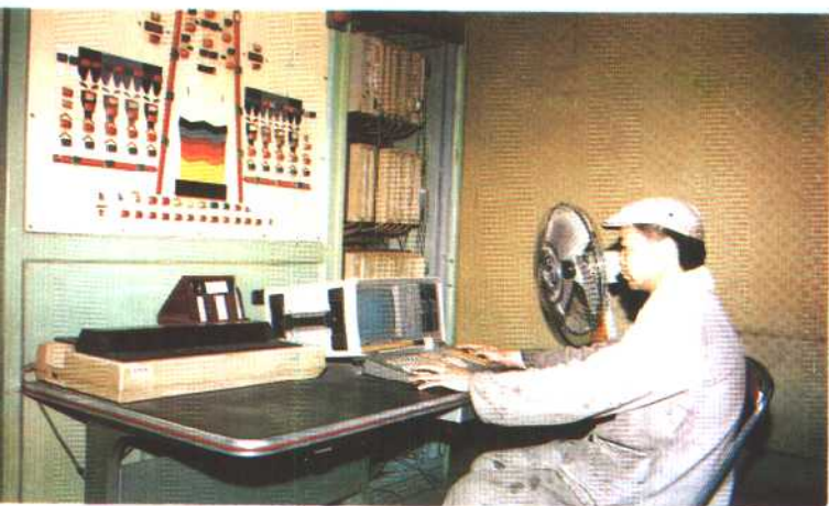
10. 2号高炉上料系统微机控制室
