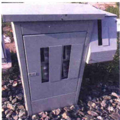
图 2-4 轨边侧箱防护设备
