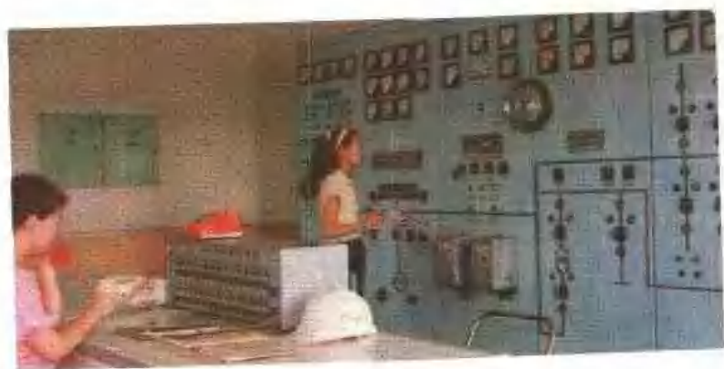
▷ 发电站主控室
