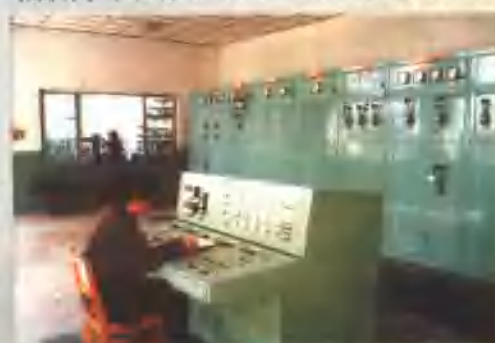
自来水公司开发区加压站日供水能力 5 万吨
