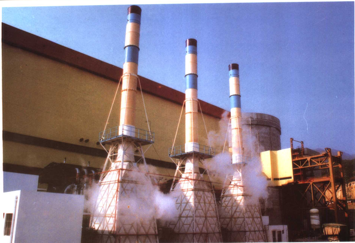
▲ 三台临时调试锅炉
