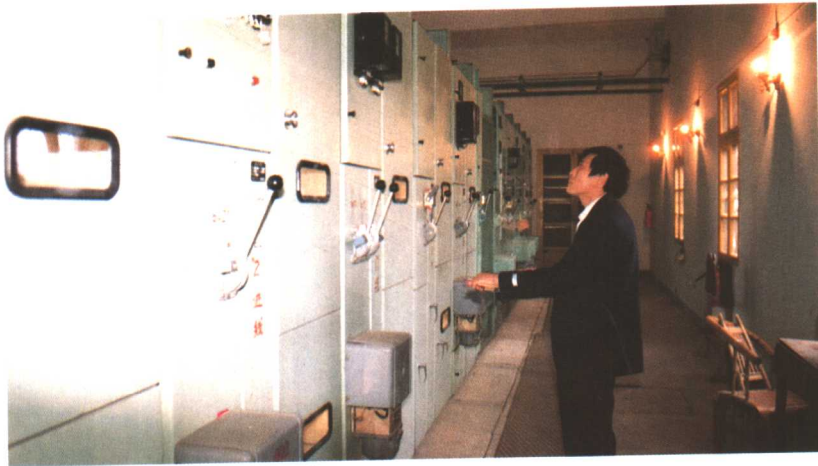
西埔变电站机房
