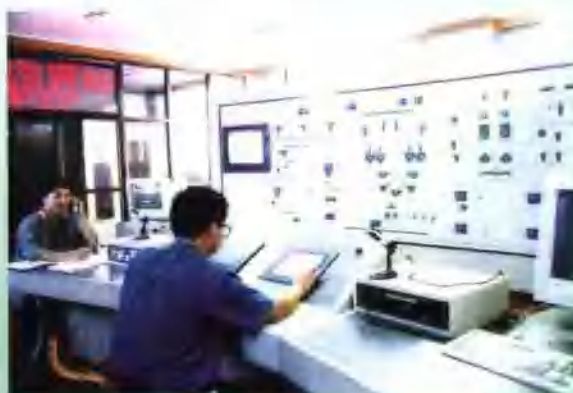
自动化控制室
