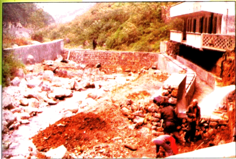
▲ 山虎关水库管理局白马供水厂源头
