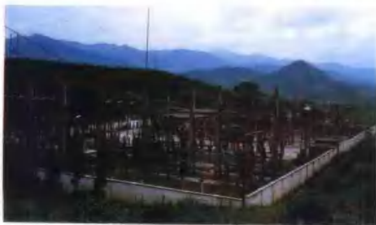
42 110千伏陵阳开关站
