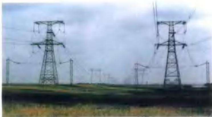
52 500千伏平繁、洛繁输电线路
