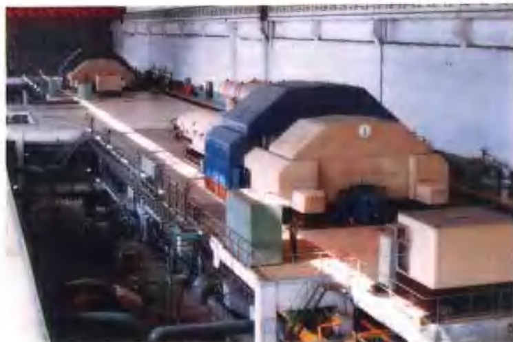
17 洛河发电厂第一期工程2台30万千瓦发电机组
