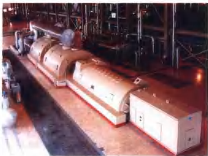
22 平圩发电厂国产第一台60万千瓦机组
