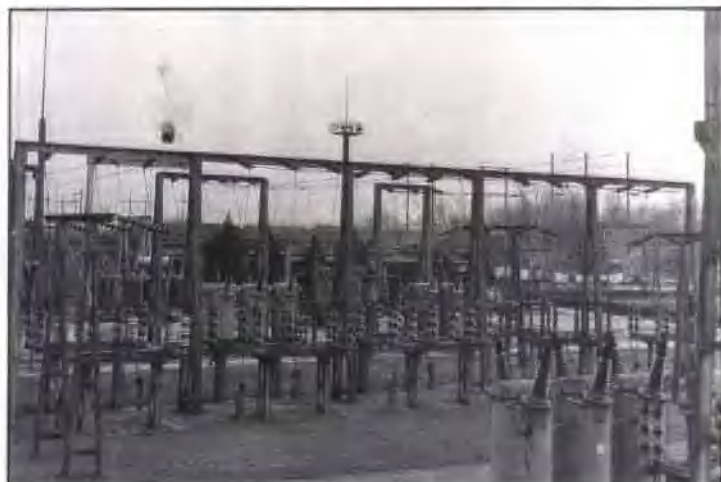
40 1958年投入运行的110千伏六安开关站
