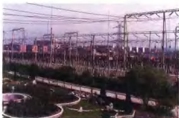
46 220千伏合肥螺丝岗变电所 (总容量36.6万千瓦安)
