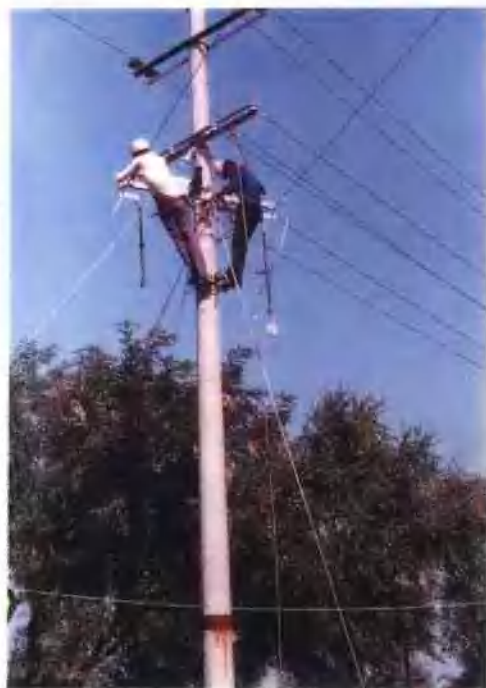
39 铜陵供电局配电设备检修
