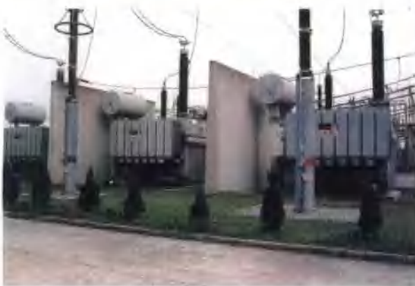
55 500千伏繁昌变电所主变压器 (容量50万千伏安)
