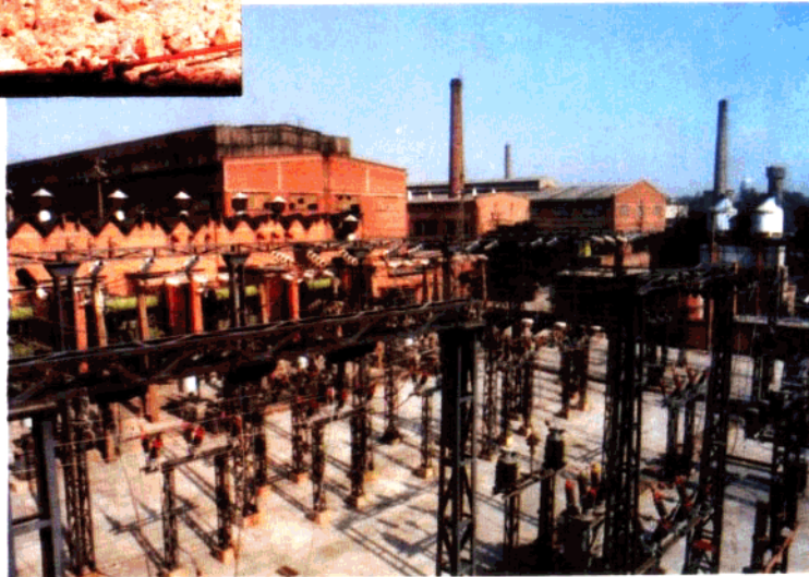
60KA铝电解系列变电站 ▷
