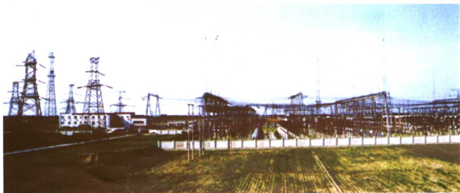
全国第一座实现达标投产的 500 千伏淄博变电站
