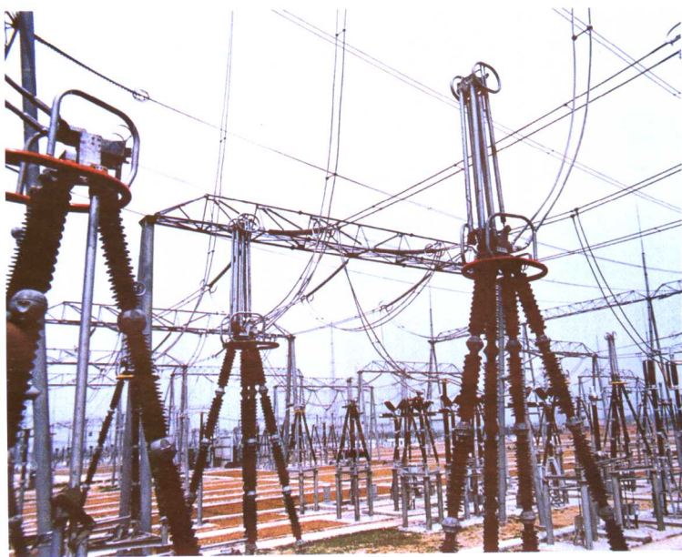
500 千伏济南变电站
