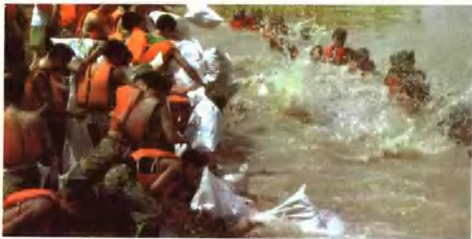
1998年夏秋，长江沿江部分堤坝被洪水泡软，出现管涌滑坡险情。
