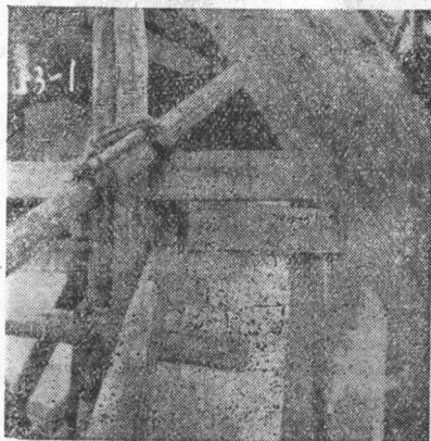
照片1 甲墙东端裂縫情况
