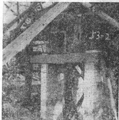
照片2 乙墙东端裂縫情况
