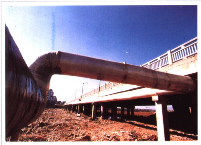
城市集中供热管道
