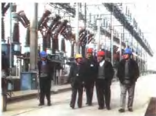
西北电网中的枢纽变——陇西 330 千伏变电站
