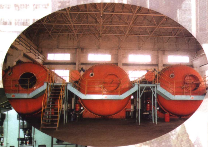
从奥地利引进的具有国际先进水平的加压过滤机
