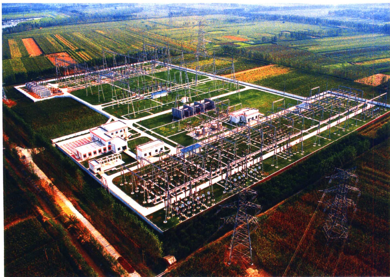
500 千伏获嘉变电站
