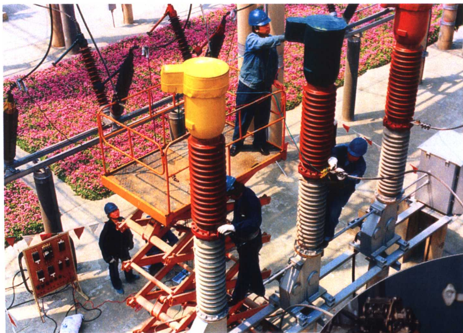
110千伏开关定期试验
