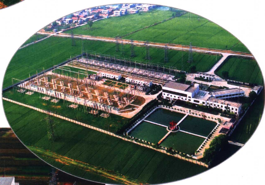
220 千伏洪门变电站
