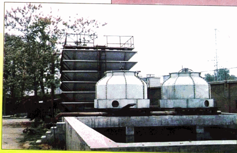
●节约用水回水处理设施
