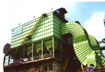
建龙钢铁公司年产60万吨矿渣微粉磨站
