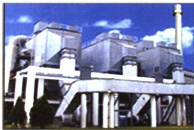
上海浦东供热电除尘器实景
