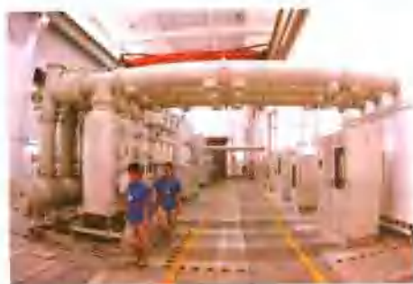
1999年5月，重庆第一座城市 中心220千伏大溪河变电站的GIS 组合电器室
