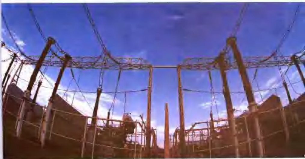
2000年3月，重庆市第一座500千伏变电站——沙坪坝供电局陈家桥变电所
