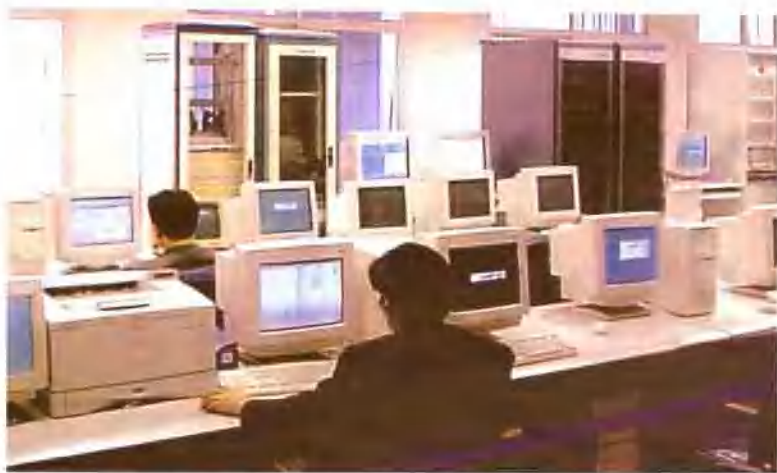
2000年重庆电力调度通信中心调度自动化机房
