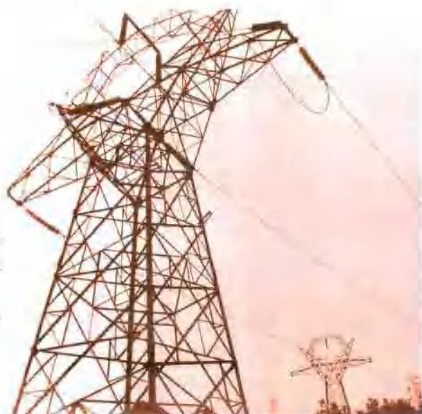
1972年5月， 重庆市第一条 220千伏输电线路—— 豆坝电厂至重庆凉亭变 电站线路
