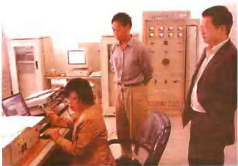
2000年重庆电力调度通信中心继电保护实验室
