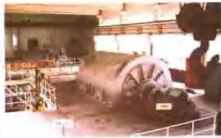
1975年7月建成的重庆市第一台调相机——雾溪变电站3000千瓦调相机
