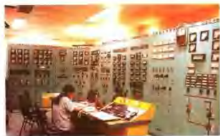
1972年3月，重庆市第一座220千伏变电站——凉亭变电站的主控制室
