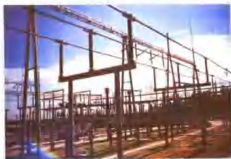
1998年7月，重庆市三峡库区 第一座220千伏变电站——万州电 业局高峰变电站
