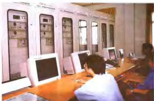
2000年长寿供电局110千伏无人值班站集控室
