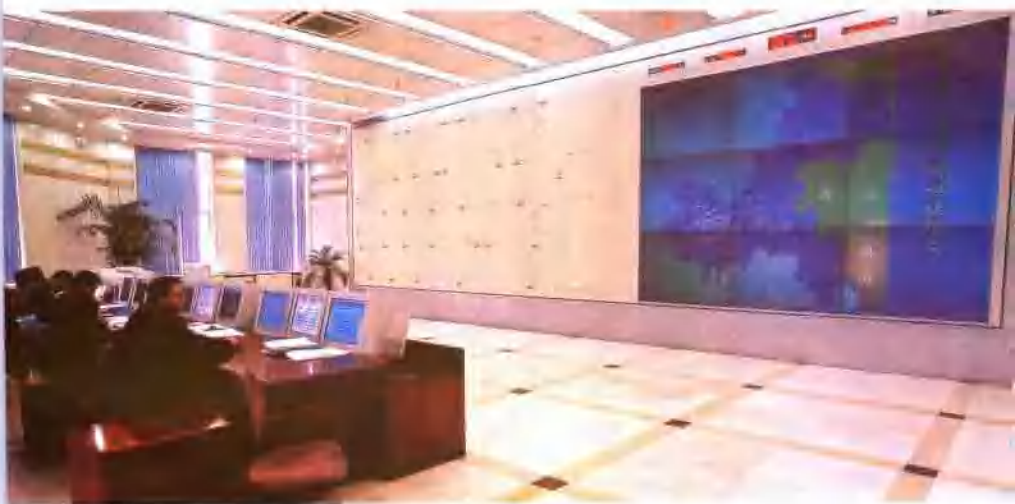
1999年重庆电力调度通信中心主控制室
