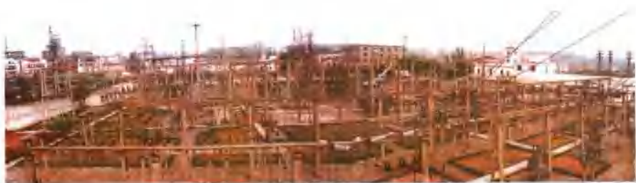
1956年12月，重庆市第一个建成的110千伏变电站——雾溪变电站
