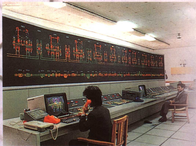
郑州-洛阳电气化铁路上安装了世界上八十年代的先进技术装备。图为洛阳电调主控室，安装的远程控制监测设备是目前国内最先进的设备
