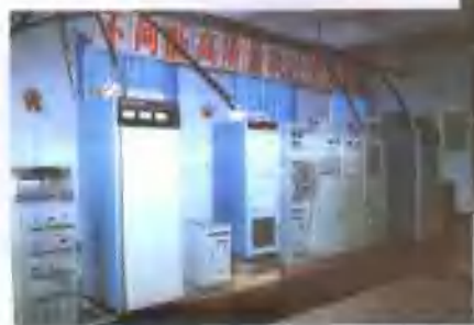
▲电视节目发射机房
