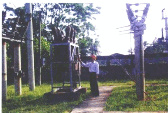
技术人员检查供电设备
