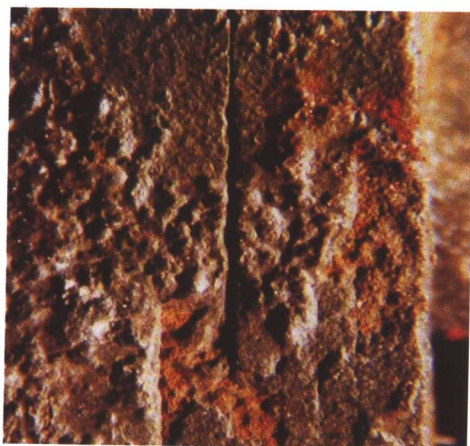
图16-15 低合金钢过热器管外表面沿圆周方向的腐蚀疲劳裂纹（放大6.5倍） （见第502页）
