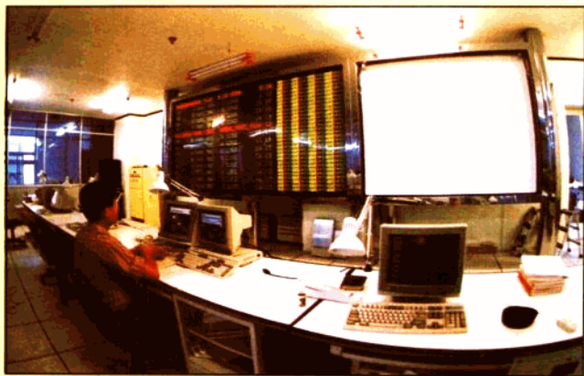
市话本地网集中监控中心
