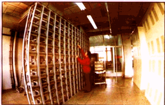
长途通信传输中心机房
