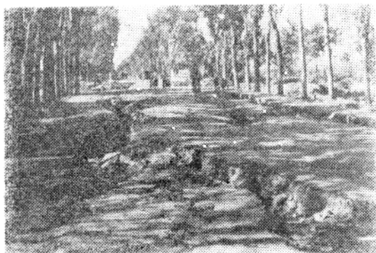
图6 在地震力作用下，公路上出现大量地裂缝
