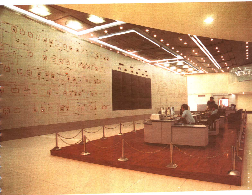
郑州地区电力调度中心
