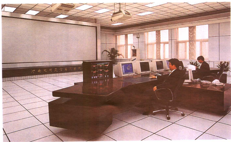
河南电力通信调度室
