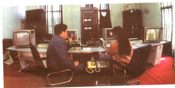
郑州地区电力负荷 微机无线监控系统
