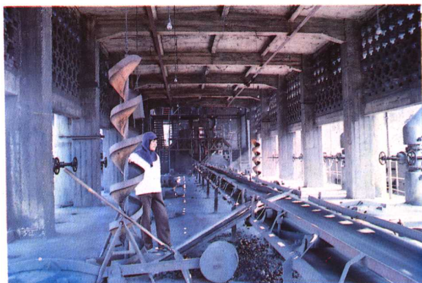
永春化肥厂石灰碳化煤球生产线
