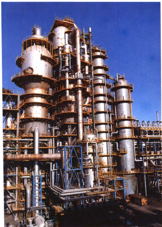
福建炼油厂催化裂化装置
