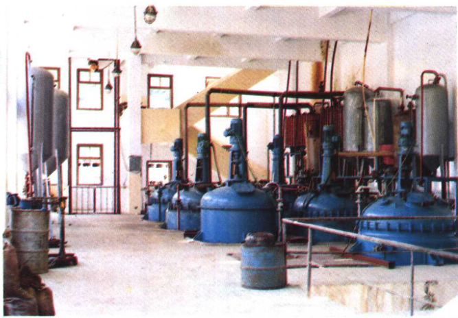
浦城生物化学有限公司发酵罐
