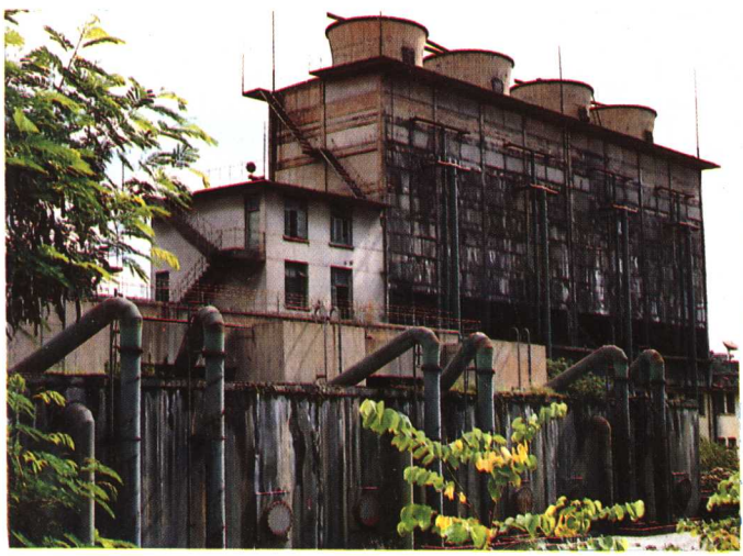
三明化工总厂污水处理装置
