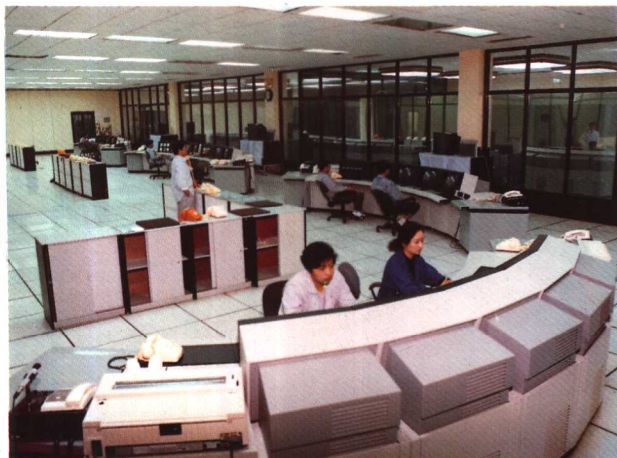
福建炼油厂生产装置中心控制室
