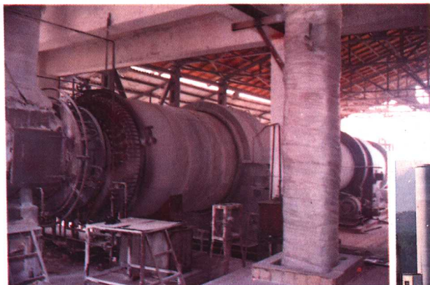
福州氮肥厂4万吨/年联碱蒸汽煅烧炉
