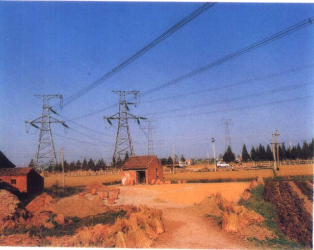
宁波电业局负责运行管理的 500 千伏北兰输电线
