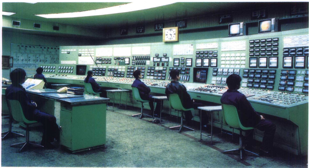
镇海发电厂 20 万千瓦机组中央控制室
