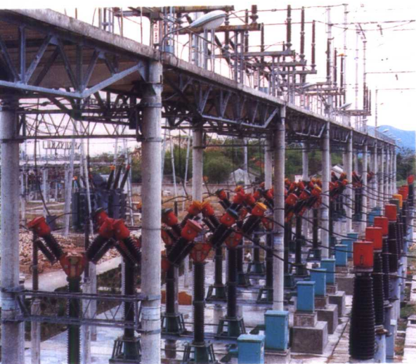
220 千伏宁西变电所开关站
