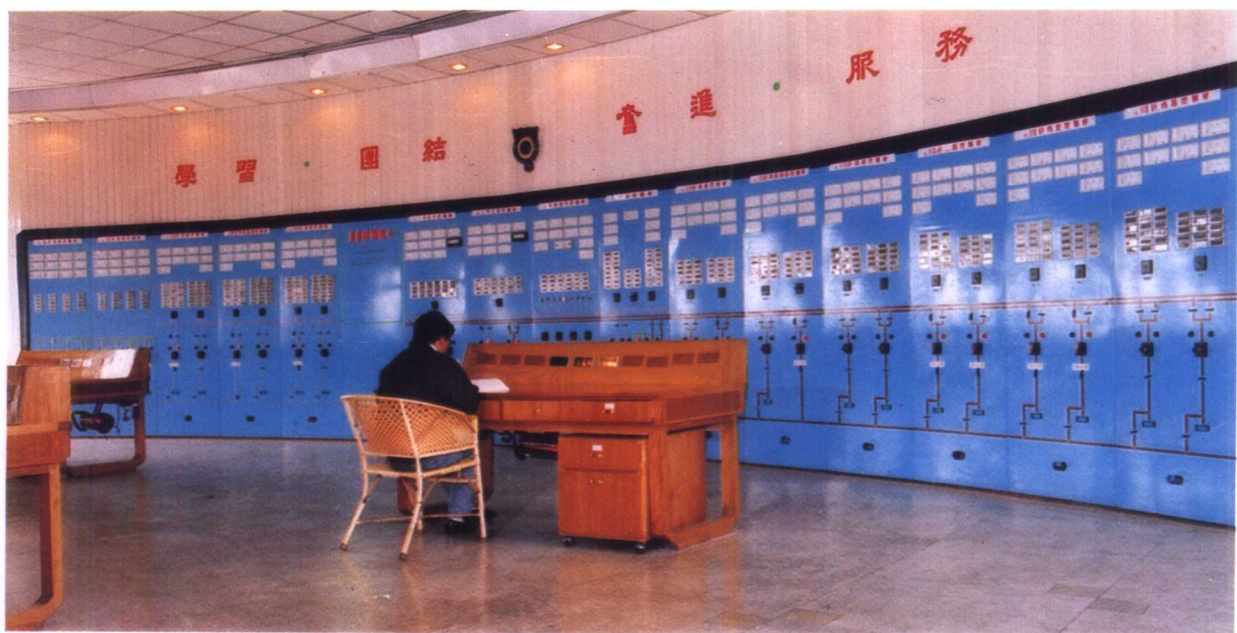
220 千伏新乐变电所总控制室
