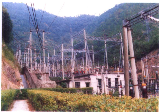
1972 年投运的 220 千伏奉化变电所
