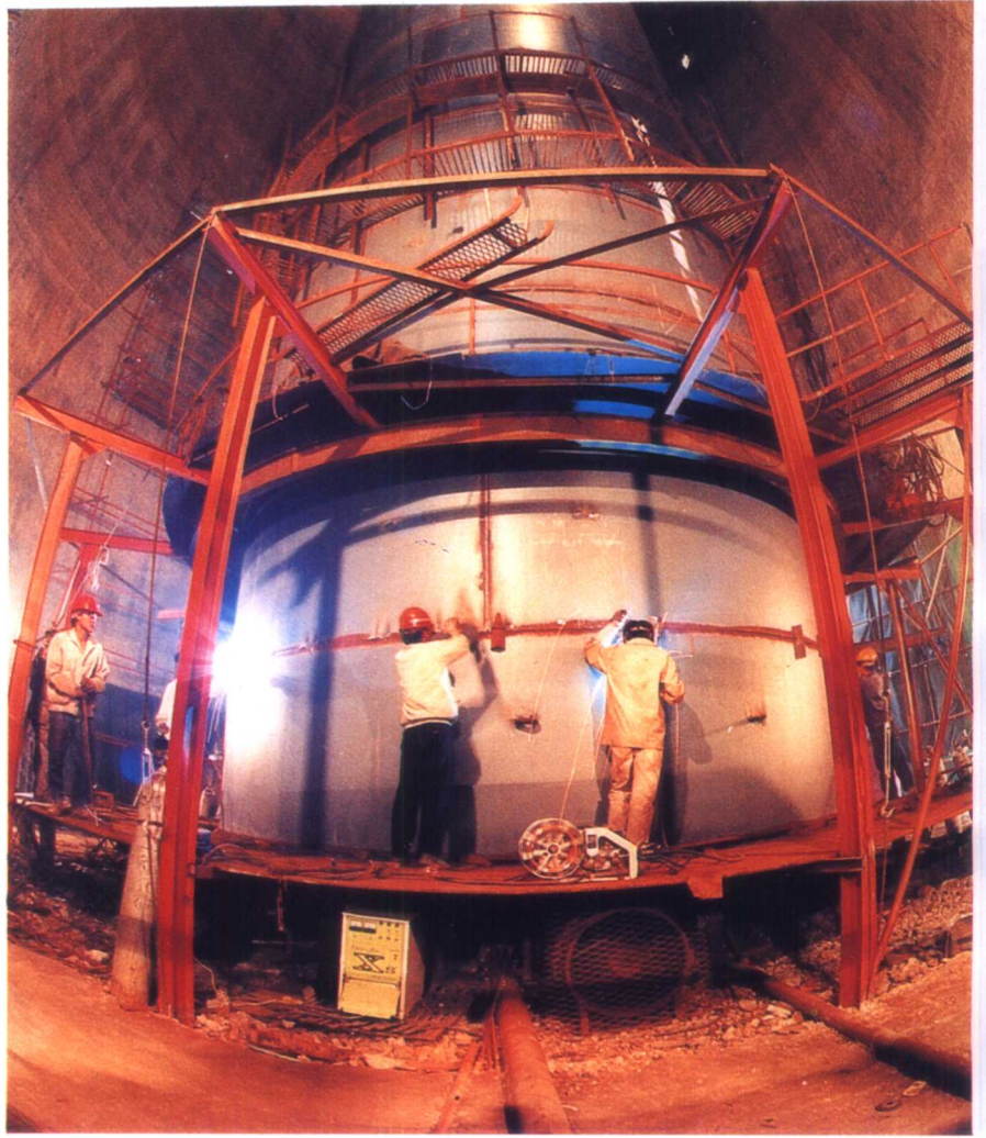
浙江省工业设备安装公司采用汽压顶升法安装 240 米高的 烟囱钢内筒
