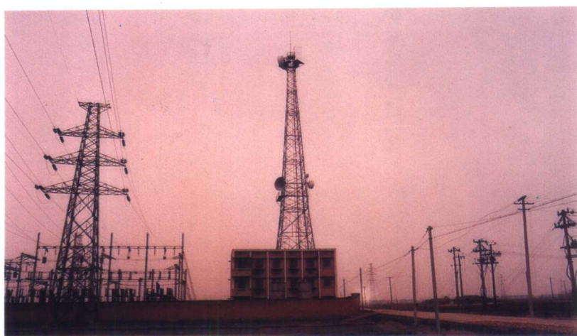
220 千伏宁西变电所微波通信塔
