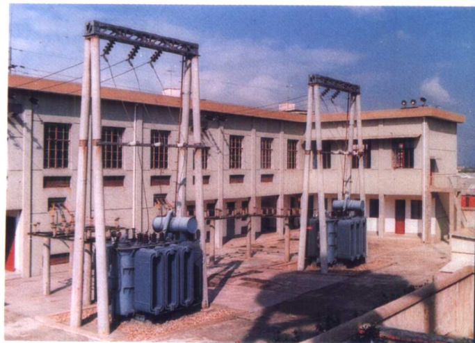
1986 年投运的 35 千伏北门变电所
