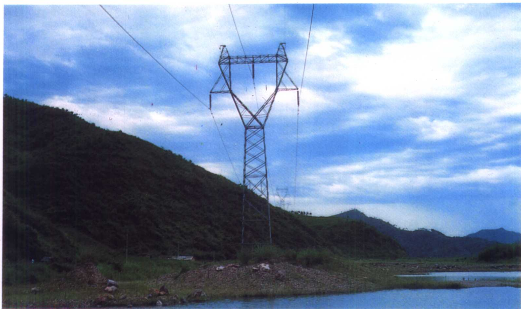
220 千伏 2307 宁奉输电线路
