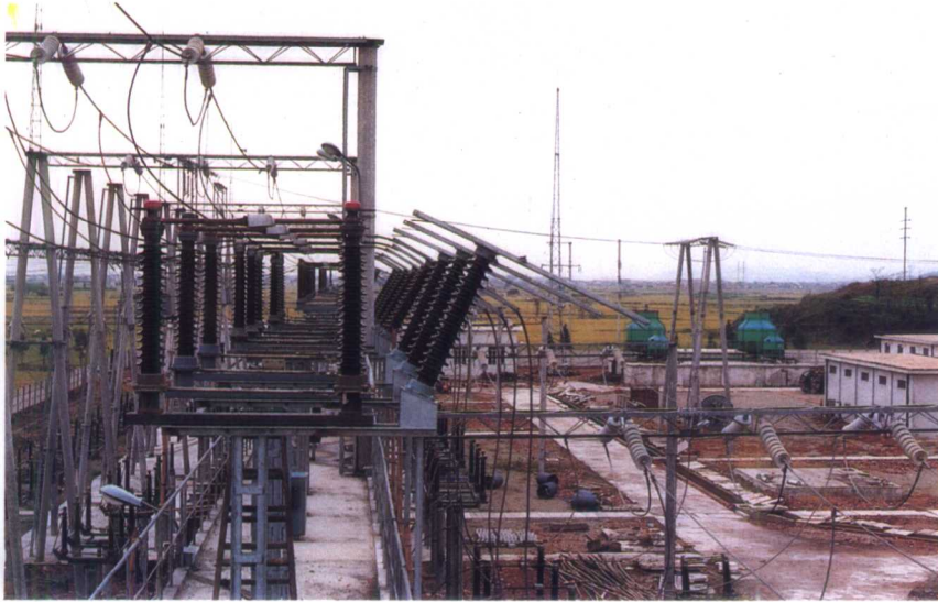
大碇整流站 110 千伏开关
