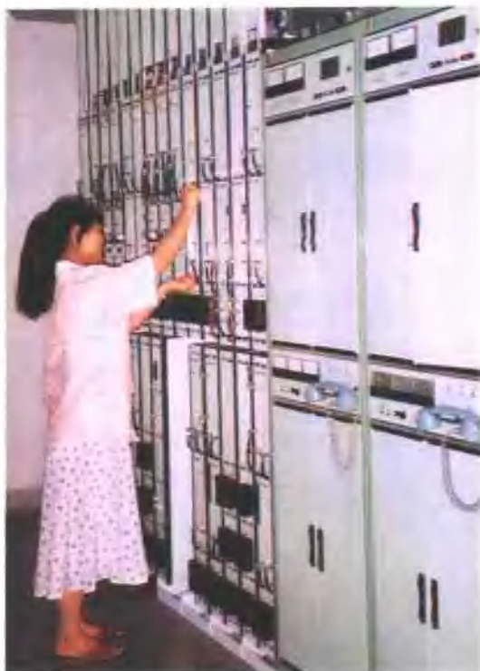
泉州微波机房
