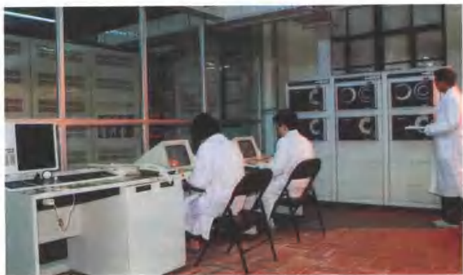
下图、泉州局程控机房
