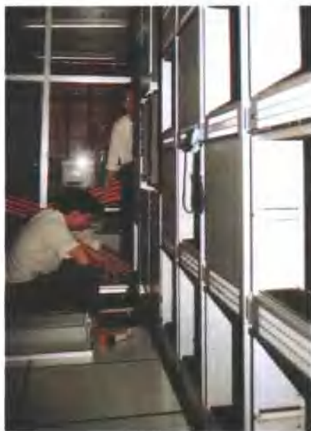
移动通信机房
