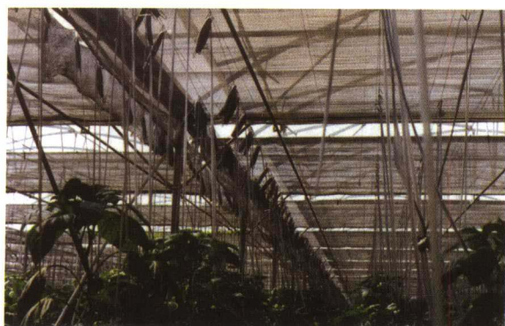
温室“内遮阳”系统
