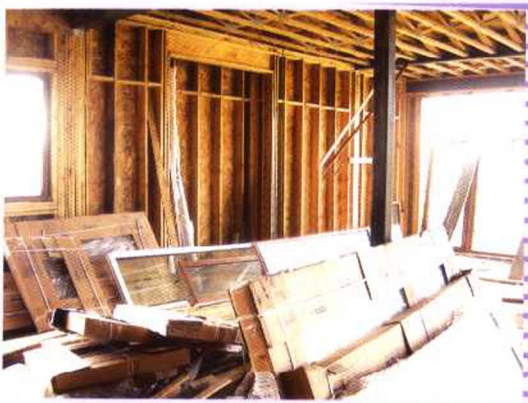
图 1.2-12 木材骨架住宅里采用钢柱
