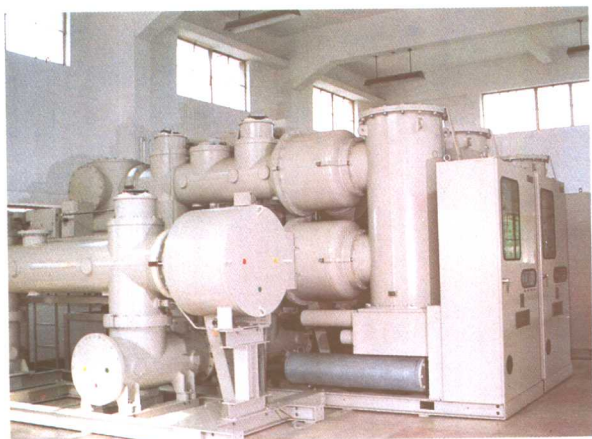
110千伏城市室内变电所——杭州昭庆变电所
