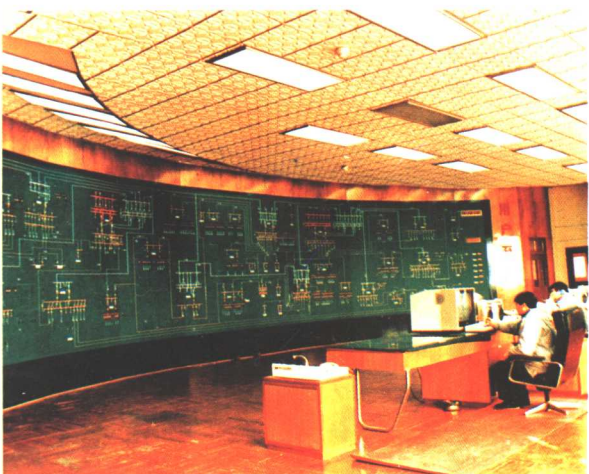
嘉兴电力局调度室
