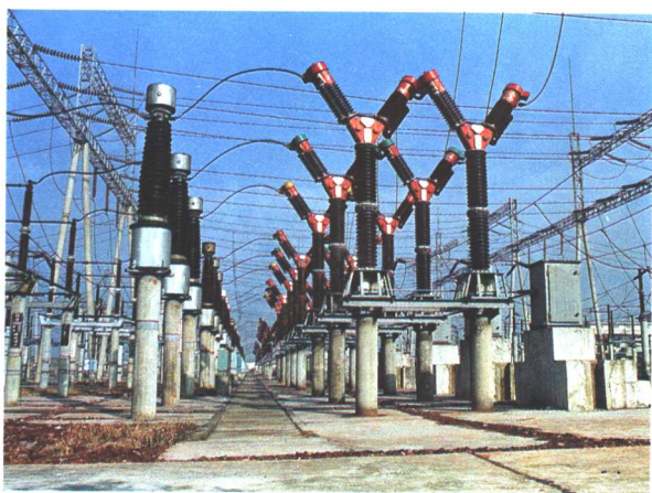
金华电业局自行设计施工的 220 千伏金华变电所
