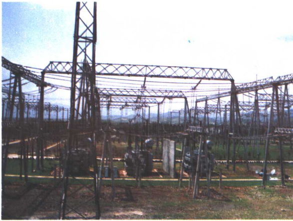
500 千伏瓶密变电所主变压器组
