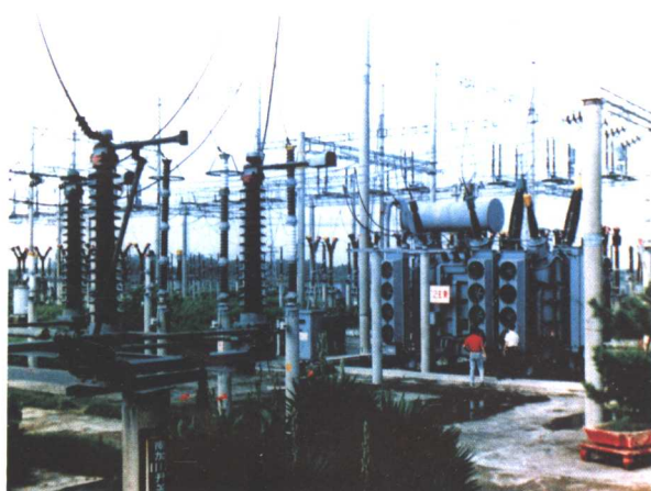
连接浙沪的 220 千伏南湖变电所
