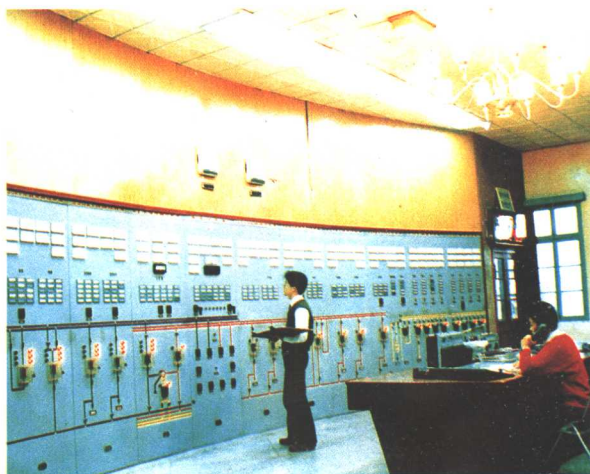
湖州电力局调度室
