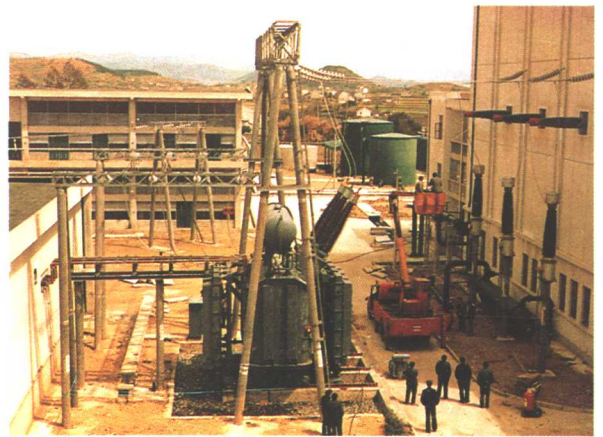
安装中的 110 千伏舟山直流输电逆变站的换流变压器、 阀厅及滤波装置
