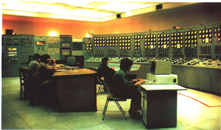
新安江水力发电厂集控室
