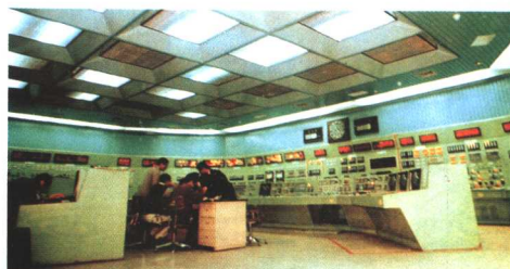
核电站集控室
