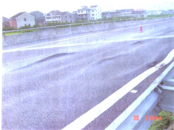
图 1-2 改性沥青 SMA 的过早破坏现象二
