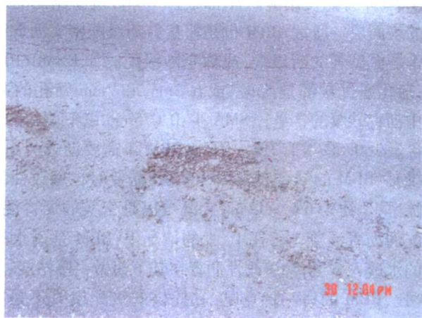
图 1-1 改性沥青 SMA 的过早破坏现象一
